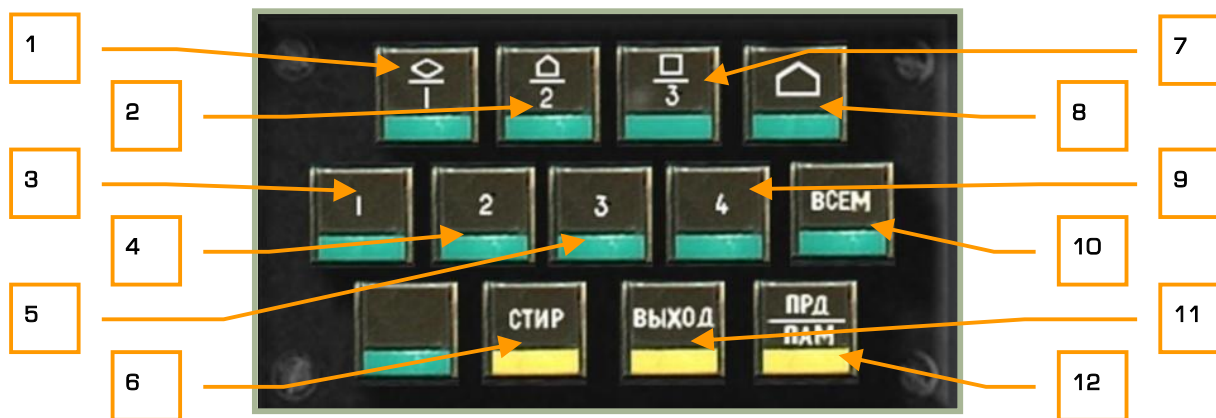
2-32: Pannello di controllo del Data link
